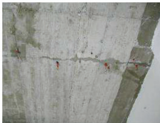
Obr. 5 Trhлина osazená pakry
